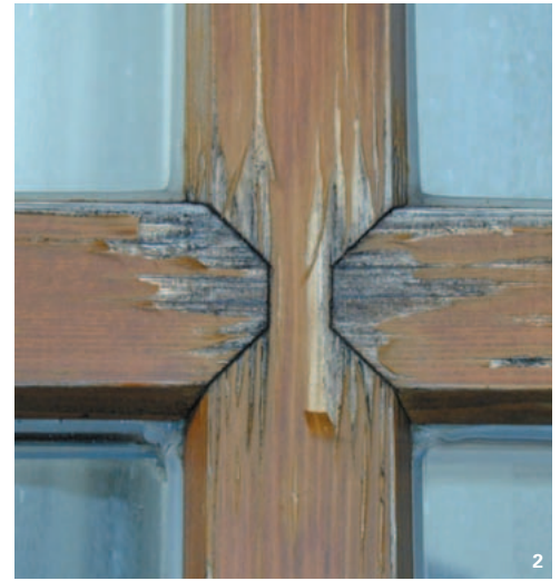
2 Die Beschichtung kann die Bewegungen in der Fuge durch Quellen und Schwinden des Holzes nicht mitmachen: Der Lackfilm reisst ab. Diese Verbindungsfugen sind daher regelmäßig zu warten
